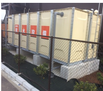
非常用給水設備
