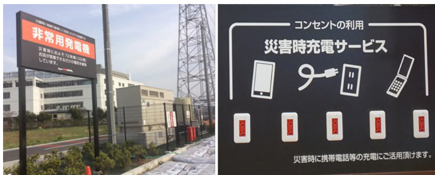
非常用発電設備と充電サービスのイメージ
